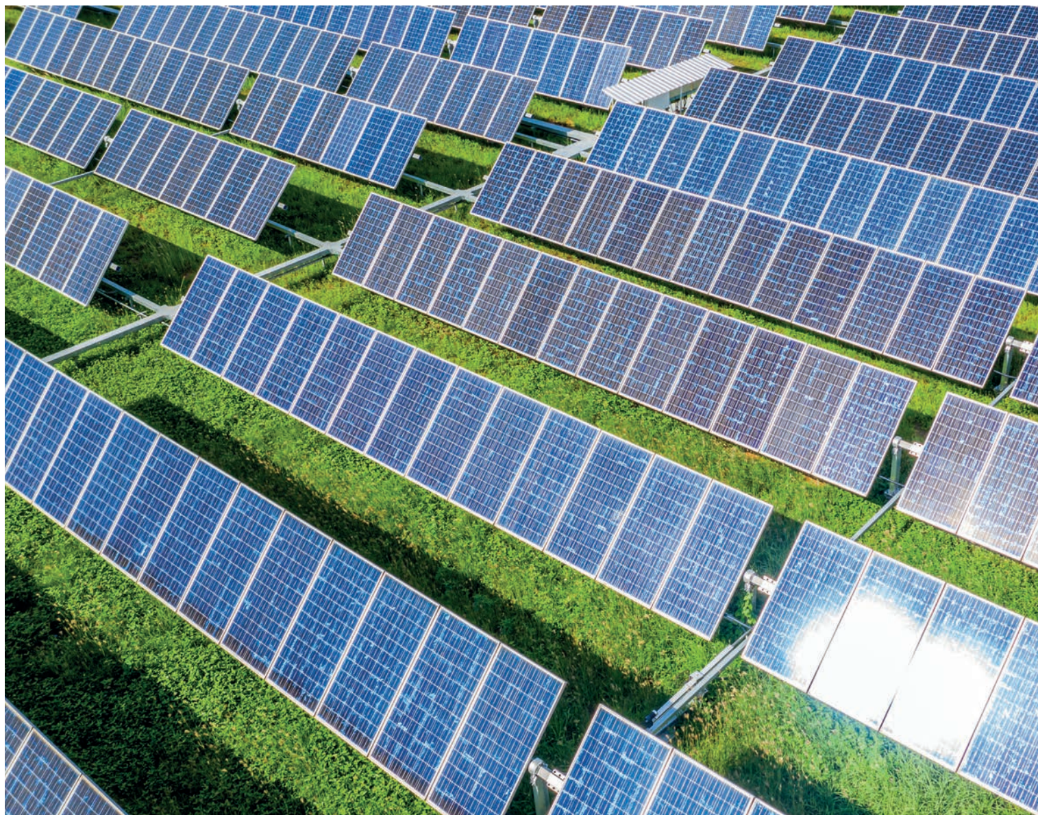
Les 25 000 panneaux photovoltaïques installés sur la zone MITRA font de Saint-Gilles la plus grande centrale solaire du Gard.
